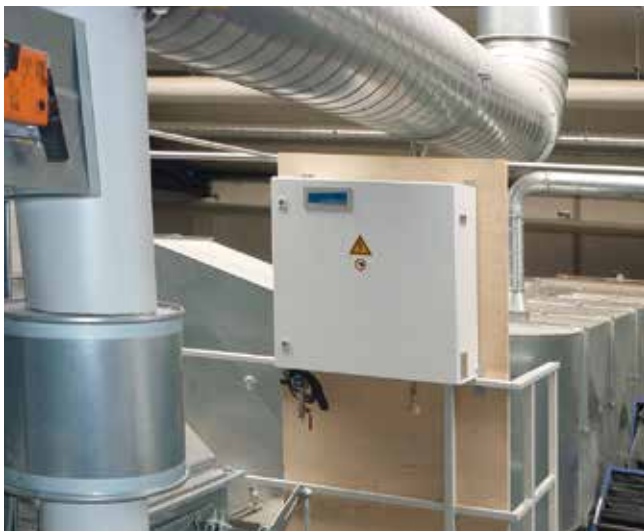
Steuerschrank über der Lackierkabine
