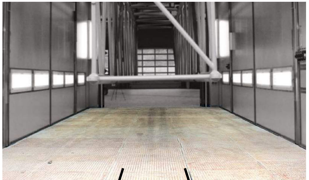
Eine konstante Funktionstüchtigkeit der installierten Gitteroste leistet einen wichtigen Beitrag zum rentablen Betrieb der Lackieranlage.
