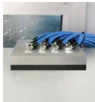
3 Anschluss am Erdungsschrank
