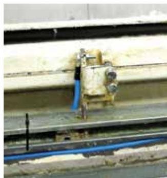
1 Anschluss der Funktionserdung an die Lackierkabine
